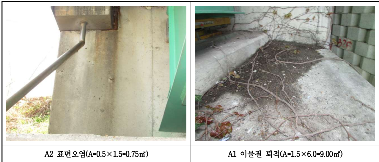
【사진 3.13】교대 손상현황(계속)
