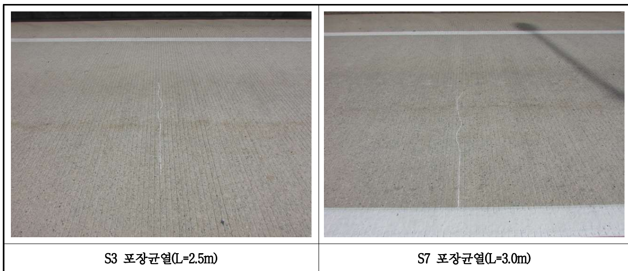
【사진 3.23】 교면포장 손상현황
