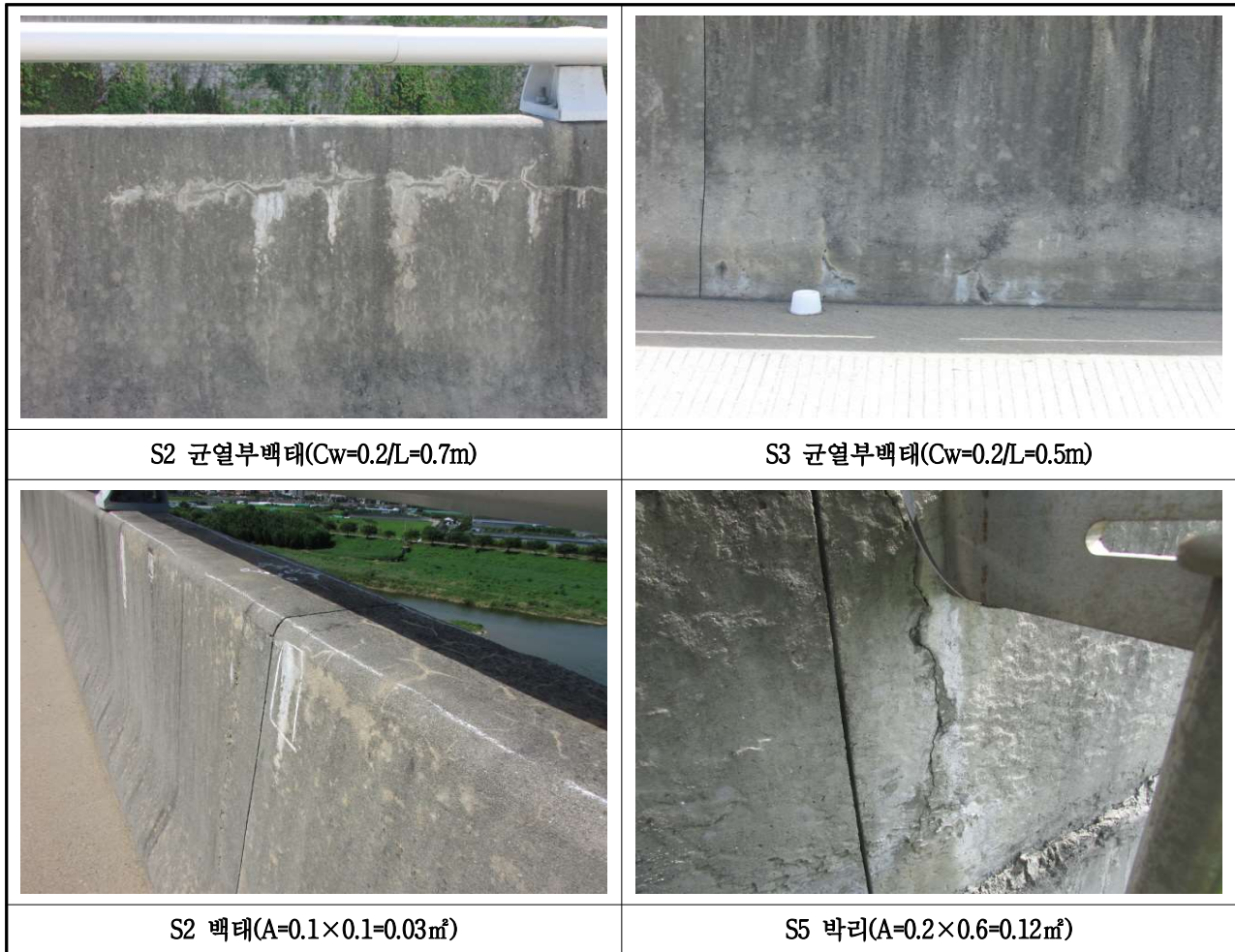
【사진 3.28】 난간 및 연석(방호벽) 손상현황(계속)
