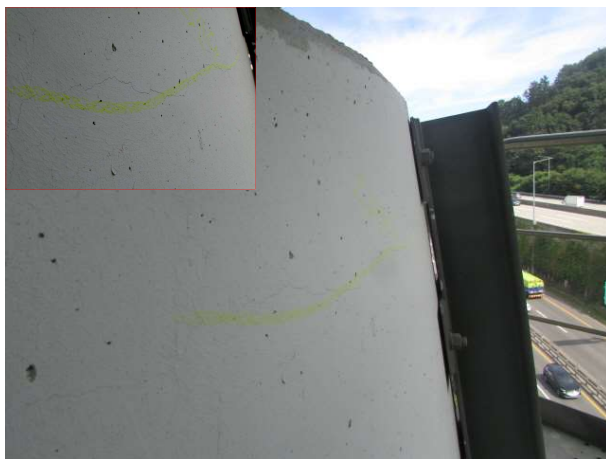
P5 보수부재균열( Cw=0.2/L=1.3m )
