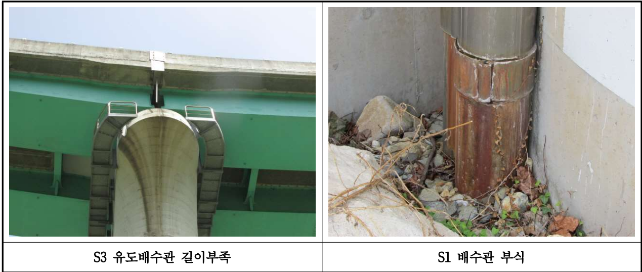
【사진 3.25】 배수시설 손상현황(계속)
